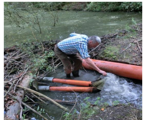
Abflussrohre im Biberdamm. Foto P. Lenk
