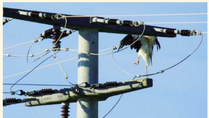
Damit solche Bilder endlich der Vergangenheit angehören, müssen die Energieversorger endlich ihren Pflichten nachkommen (Foto: E. Taube)
